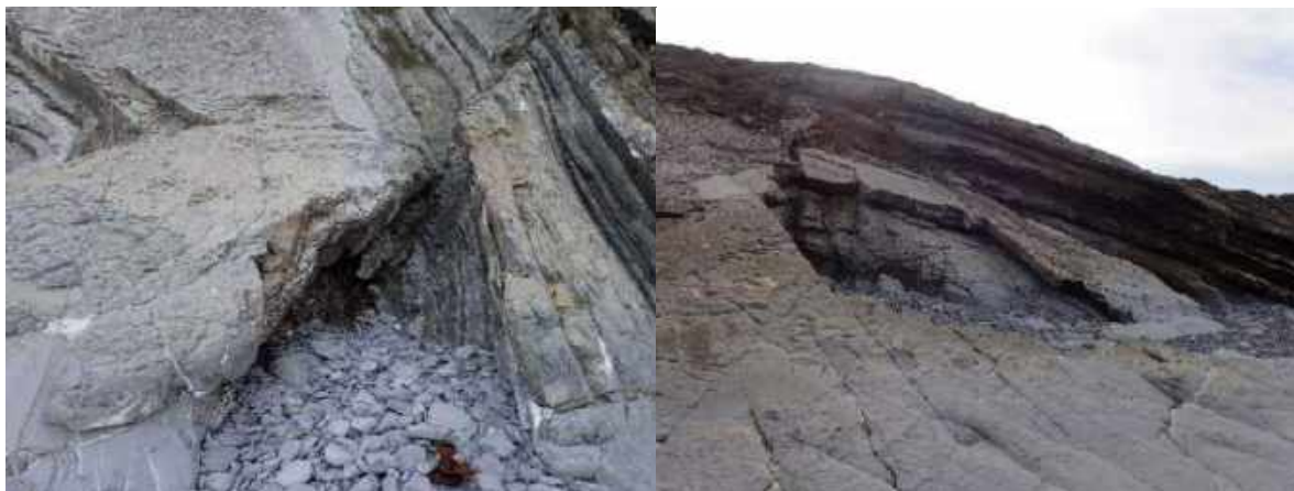
Figure 27 (à gauche) : Exemple d'arrivée d'eau sur fracture en pied de falaise sur tronçon 9 Figure 28 (à droite) : Exemple de pied de falaise bréchique au tronçon 15 (ablation marine)
