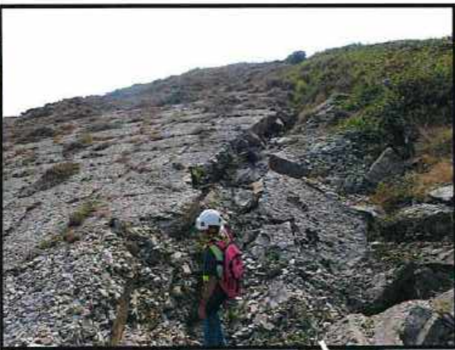
Rupture latérale et fragmentation des dalles en mouvements Epaisseur glissée de 1.5 m (Cerema 07-2020)
