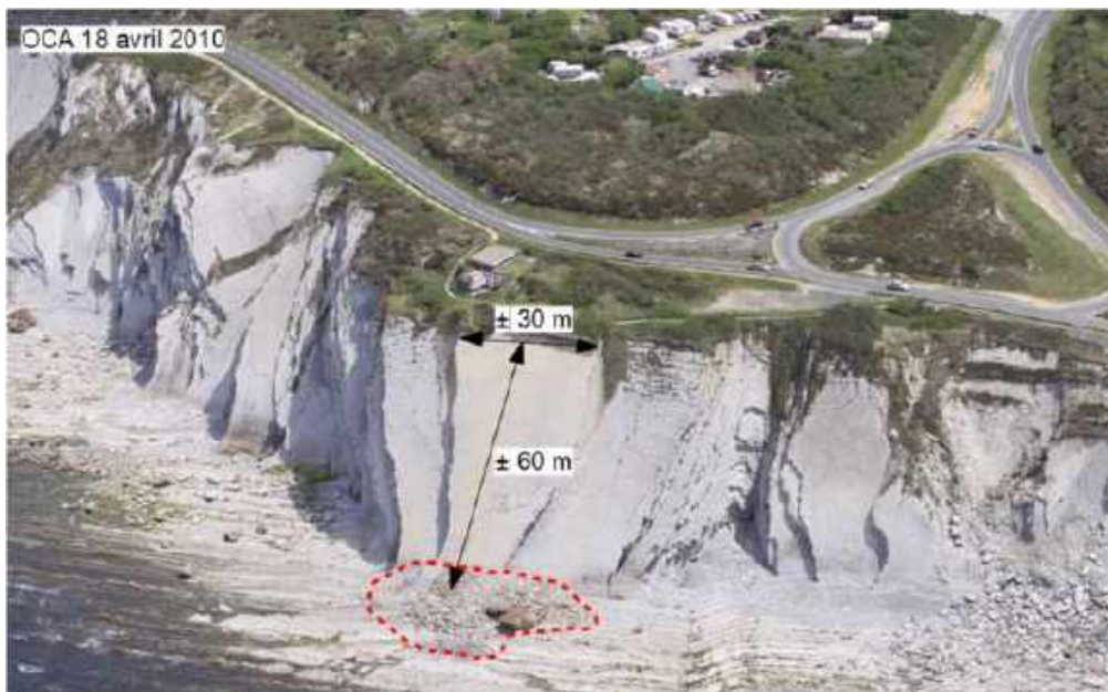
Figure 34 : Photo après effondrement - 18 avril 2010 - Secteur 6
