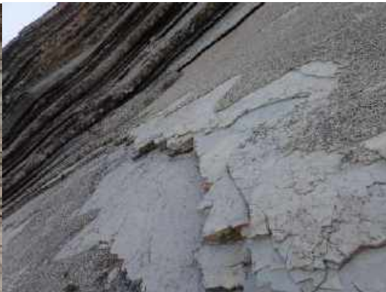
Figure 21 : Ecaillage massif (plurimétrique) au tronçon 9
