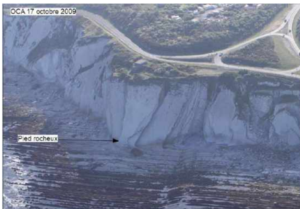
Figure 33 : Photo avant effondrement - 17 octobre 2009 - Secteur 6
