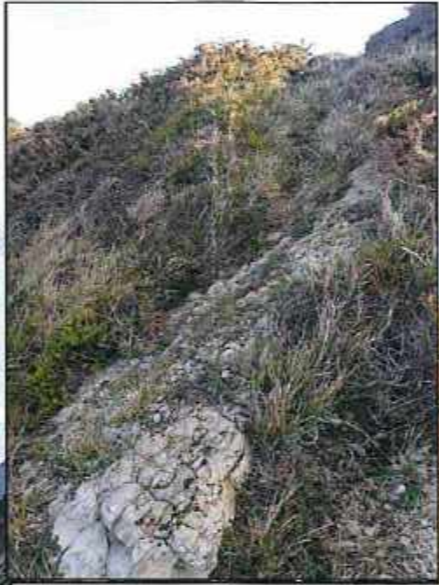
Dalles bréchiques instables (Cerema 02-2021)
