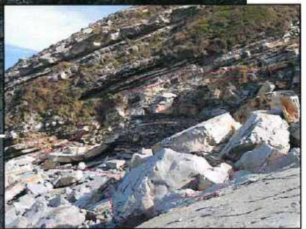
Ancien écoulement de grande ampleur – 5 m d'épaisseur (Cerema 02-2021)
