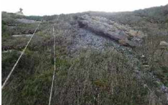
Figure 22 : Glissement de dalle (local) tronçon 9
