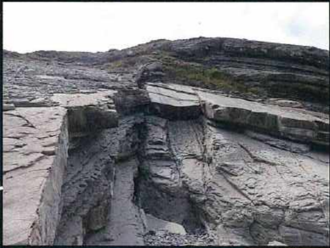
Écroulements dans une zone de fractures (Cerema 07-2020)
