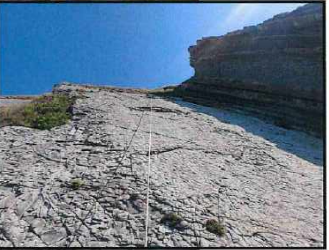
Dalles rocheuses fracturées avec brèches et écaillages (Cerema 07-2020)
