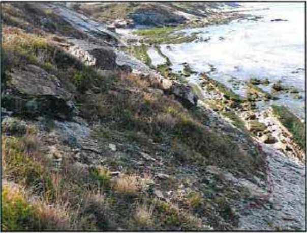
Glissement pseudo-rocheux d'environ 1.5 m d'épaisseur (Cerema 02-2021)
