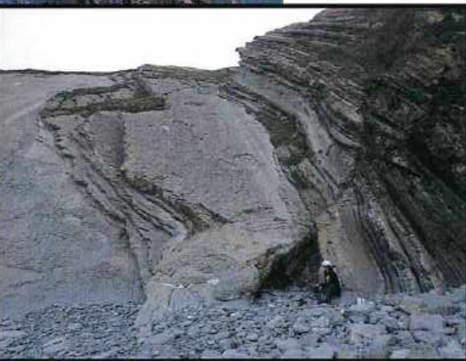
Pied de falaise très fracturé (dalles A fragiles) avec arrivée d'eaux en fracture (Cerema 02-2021)
