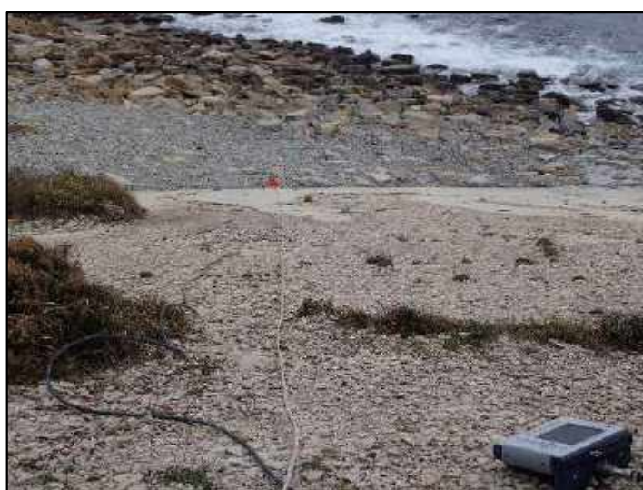
Mise en œuvre du radar géologique sur la paroi de la falaise du secteur 15B (source Cerema)
