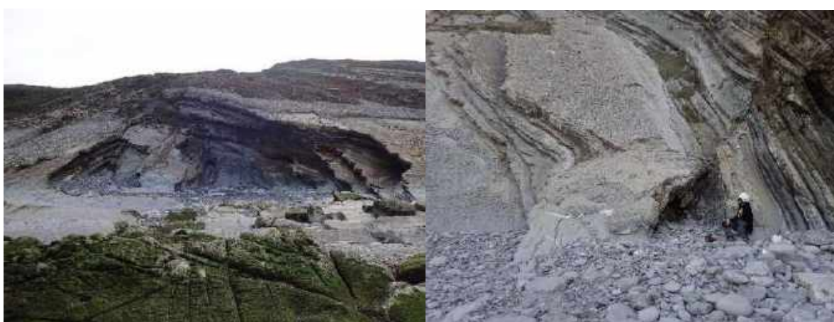
Figure 29 (à gauche) : Exemple de sous cavage développé à la faveur d'un pli tectonique au tronçon 15 Figure 30 (à droite) : Exemple de sous cavage développé à la faveur de fractures au tronçon 9
