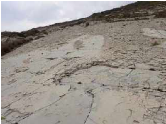
Figure 20 : Ecaillage superficiel (tronçon 15)
