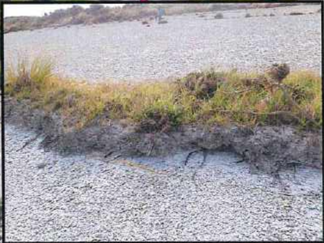
Glissements superficiels de la terre végétale sur une dalle fragmentée (Cerema 07-2020)
