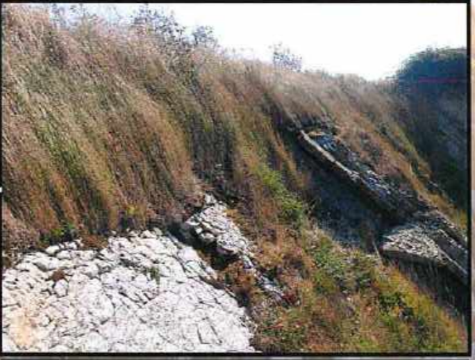
brèches et écaillages de dalle A en place Dalle B décollée (bombement) (Cerema 02-2021)
